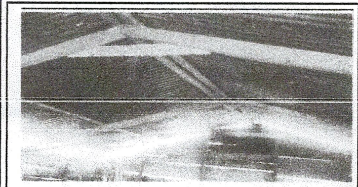
Foto 3: En esta imagen se observa la necesidad de sustituir el techo y la estructura que la sostiene
